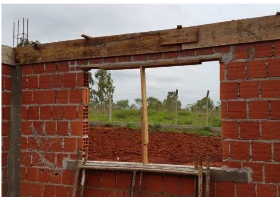
Figura 5– 17/10/2018 – janelas sem vergas
