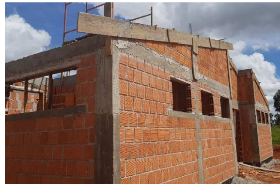
Figura 4– 07/11/2018 – falta de acabamentos na alvenaria
