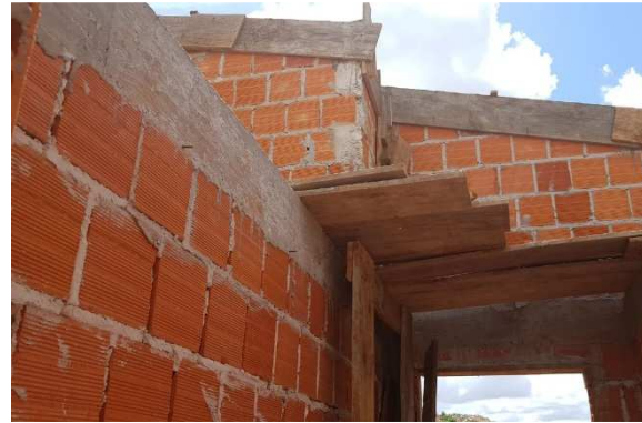
Figura 2– 07/11/2018 – falta de acabamentos na alvenaria
